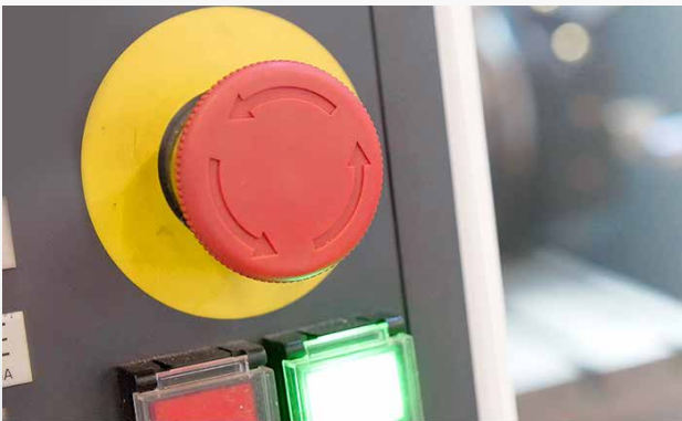
Fig. 2: Los interruptores de parada de emergencia deben ser fácilmente visibles
